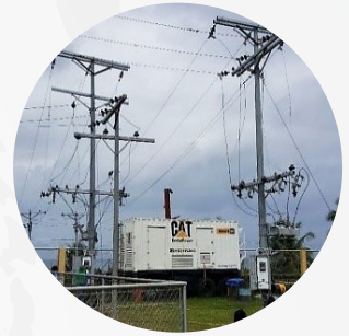
CONEXIÓN A GENERADORES
