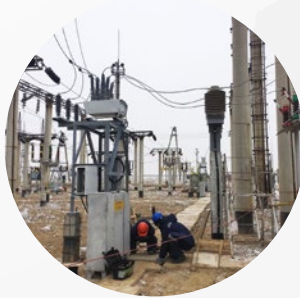
INTERRUPTOR DE SUBESTACIÓN
